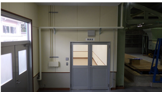
教員室（雨漏りの修繕）
