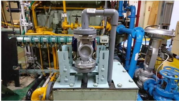
図1 ターボチャージャー潤滑油流量計及び配管
