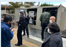
内燃機関発電システムの遠隔監視 (学生寮あかつき寮地区)
