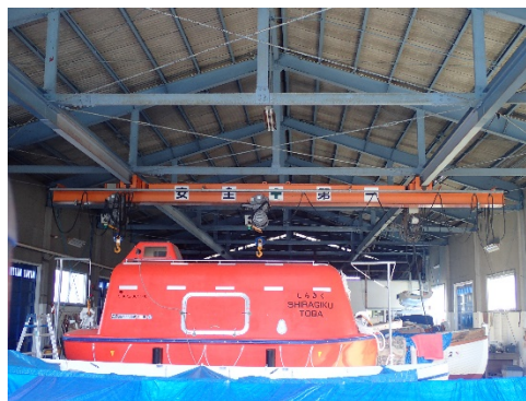
図2：天井クレーン
